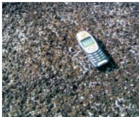
Obr. 1: Klasický polystyrenbeton na střeše s nesoudržným povrchem (penetrovaný)
