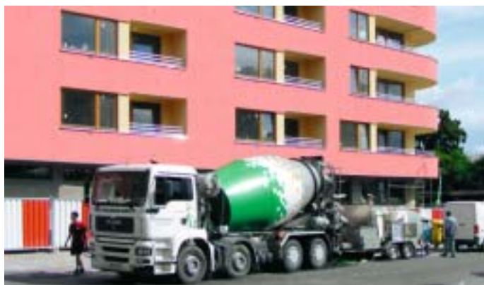
Obr. 6: Čerpadlo je přistavováno pouze na dobu lití Porimentu a je na stavbě naprosto nezávislé
