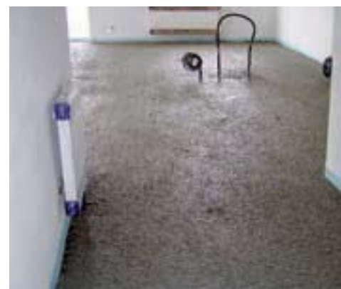
Obr. 8: Rozvody zalité v podlaze, Poriment P – 300
