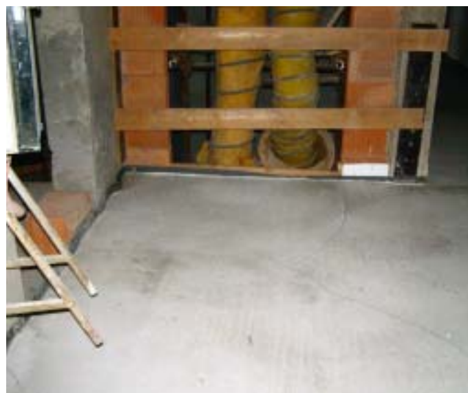
Obr. 7: Trhлина vzniklá z důvodu rychlého vysušení potěru
